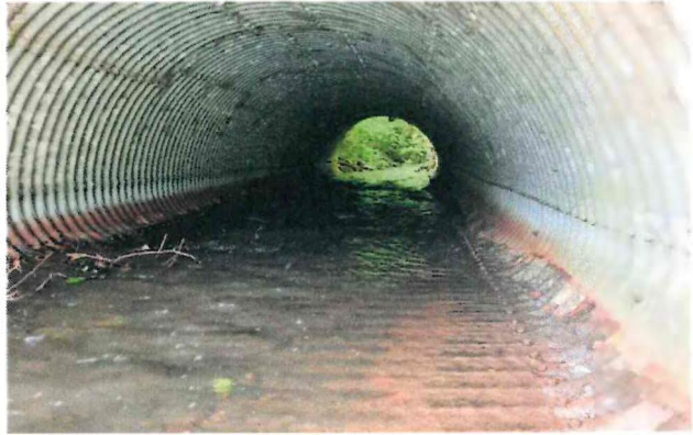
Abbildung 2: Wellstahlprofil mit Korrosionsschäden, teilweise vollständige Durchrostung.
